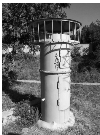
Рис. 3. Существующие в настоящее время установки сухой химической фильтрации в парковой зоне
